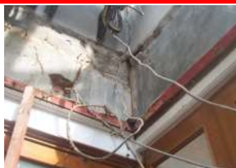
Serangan pada komponen bangunan di dalam ruangan
